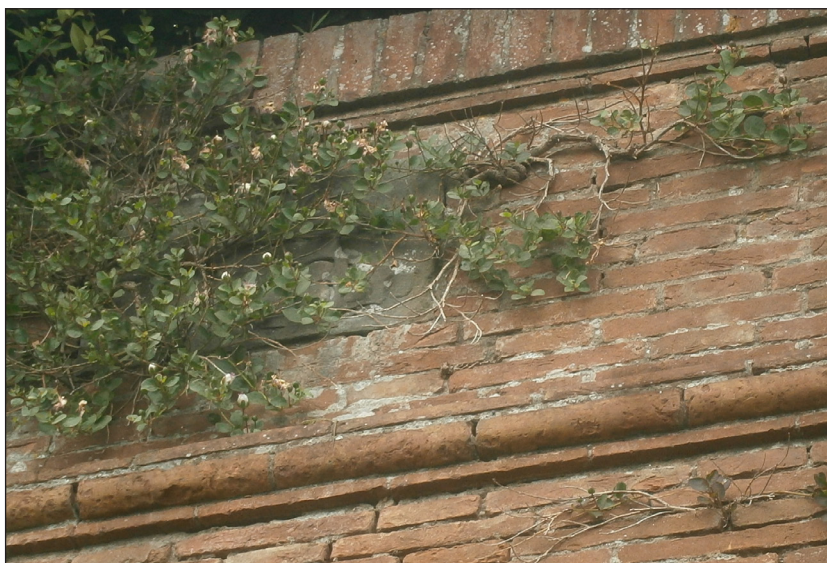
La lapide deteriorata e coperta dalle piante di cappero
